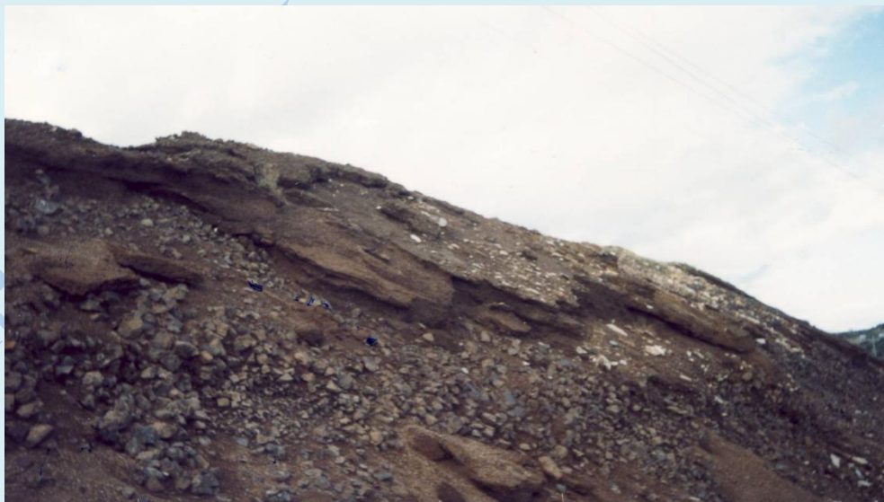
Φωτ. 2 Αποτυχημένη βλάστηση. Έλλειψη αποστραγγιστικών. Διατάραξη του πρανούς από τη διάνοιξη δρόμου.
