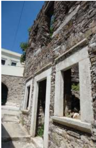
Θυρώματα ετοιμόρροπου κτιρίου στον παραδοσιακό οικισμό Σκαδού Νάξου
