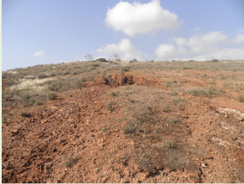
Φωτ.1. Προδρομική εξυγίανση σωρού απορρίμματος με σύστημα συλλογή εκχύλισης μετάλλων (έλεγχος όξινης απορροής). Σημ. Δεν λήφθηκαν μέτρα αποστράγγισης στην εκσκαφή του συστήματος συλλογής της εκχύλισης, με αποτέλεσμα την καταστροφή της φυτικής γης και της βλάστησης.
