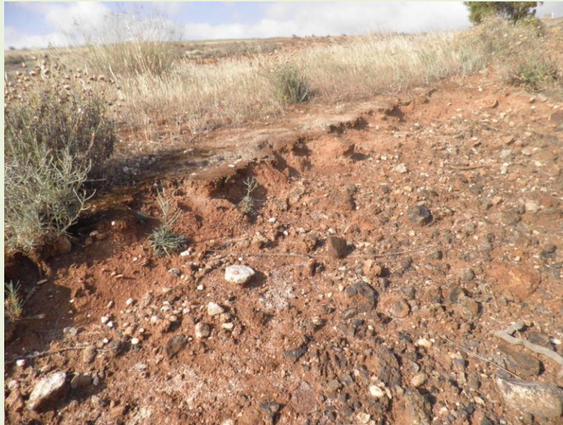
Φωτ.3. Καταστροφή φυτικής γης εξαιτίας της έλλειψης αποστραγγιστικών έργων. Παρασύρθηκε όλο το δεξιό τμήμα με τη ροή διαφυγής του νερού της βροχής.
