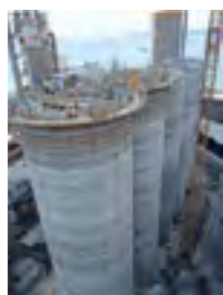
■ Τσιμέντα ΧΑΛΥΨ. Τα νέα σιλό αποθήκευσης πρώτων υλών
